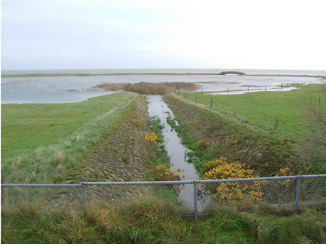
Über ein massives Einlaufbauwerk werden Flughafenflächen in die Jücker Marsch entwässert – Hochwasser in der Jücker Marsch/ Brücke im Hintergrund
