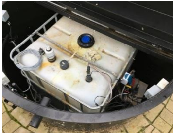
Fällmittel Tank [Eisen III-chlorid]
