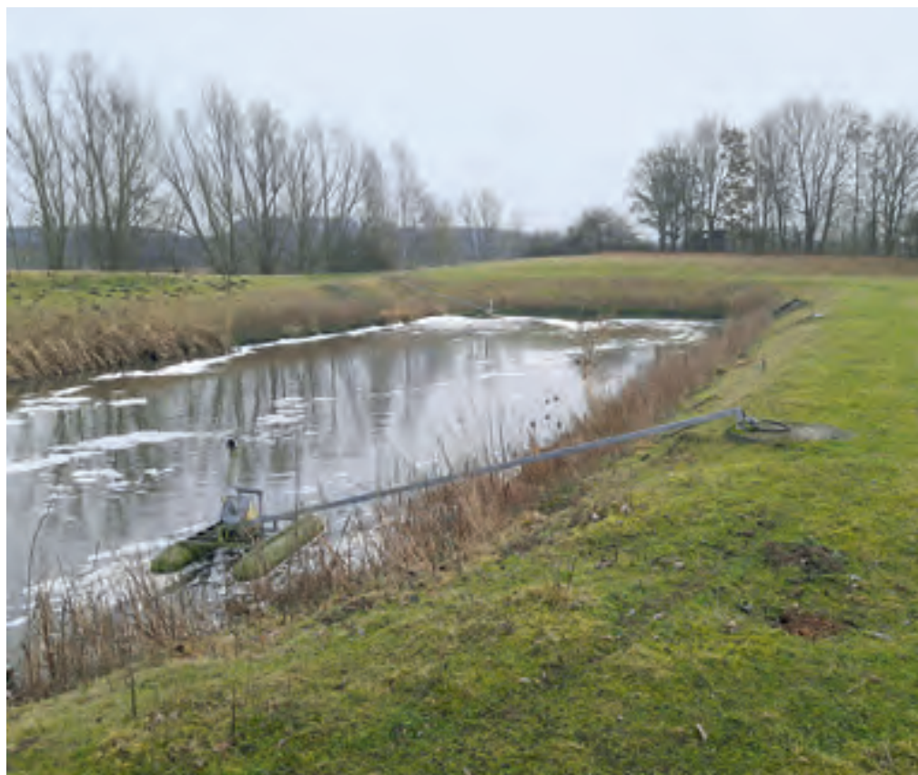
Kläranlage Mustin: belüfteter Klärteich mit P-Fällung
