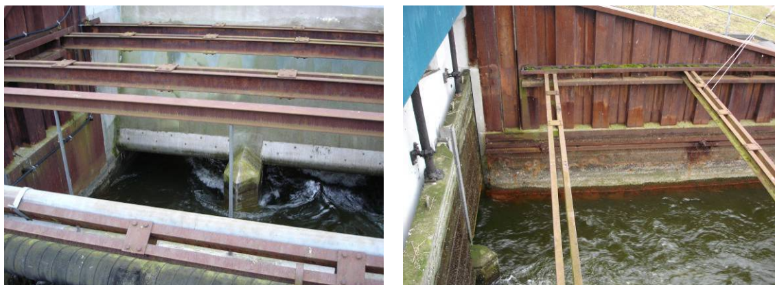
Abb. 8: Wehranlage im Auslauf des Großen Binnensee
