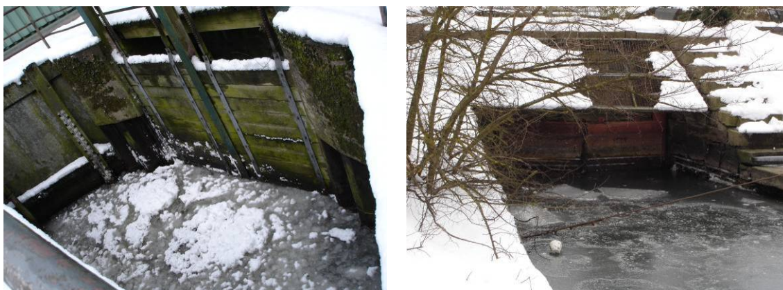
Abb. 95: links: unterströmtes Wehr; rechts: Rückschlagstore
