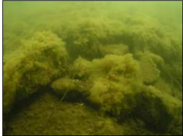
Foto 66: Algenüberzüge im Bereich der Steinschüttung.
