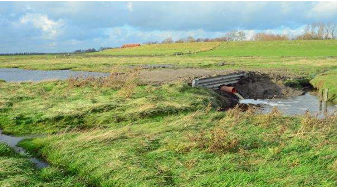
Abb. 14: Reparierte Überfahrten und Staue im Olversumer Vorland; 2014
